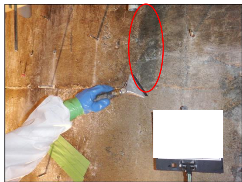
図4.15.8 コンクリート壁面に残った石綿の除去（スクレーパカッター）
