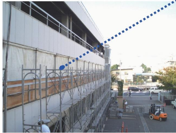
図 4.7.18 外壁開口部の飛散防止養生（既存手すりを活用し、防災シートとベニヤ板を使用して負圧隔離養生の破損を防止）
