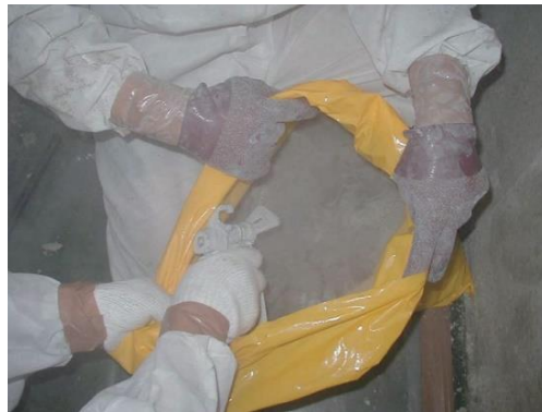
図 4.7.76 袋詰めした石綿廃棄物への粉じん飛散防止処理剤を散布
