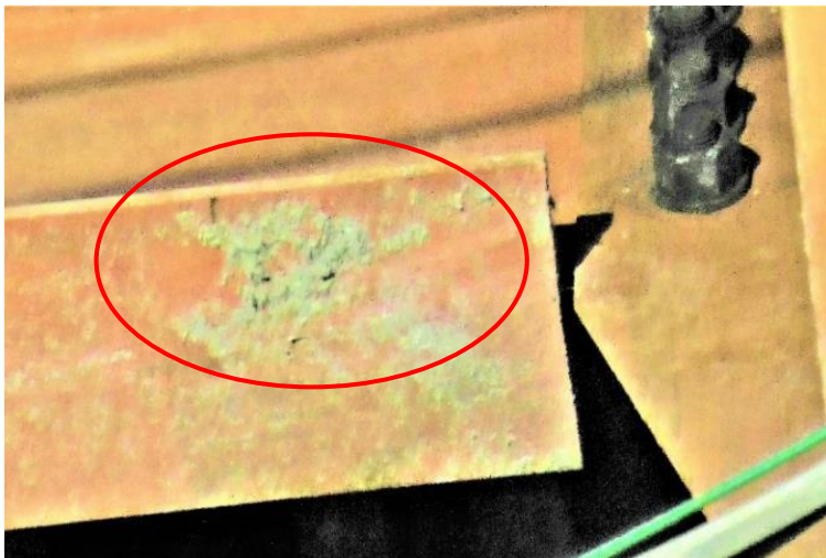
鉄骨梁下の取り残し
