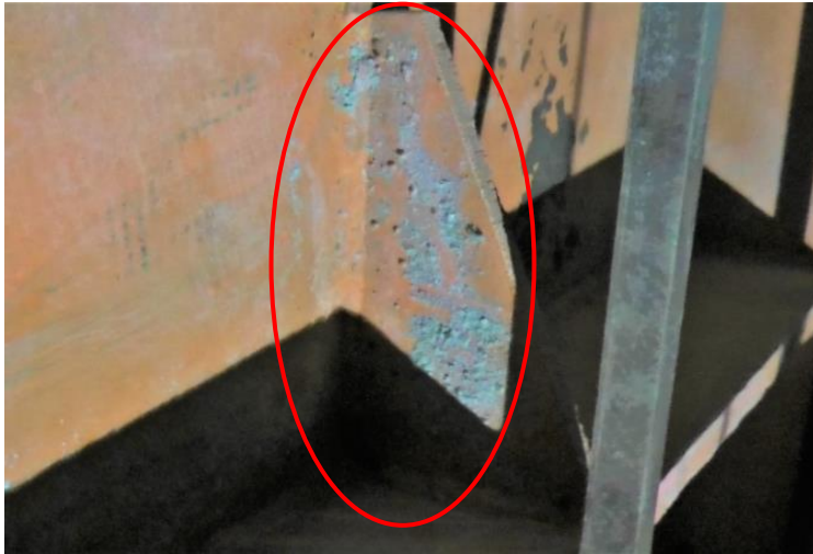
鉄骨梁側面の取り残し
