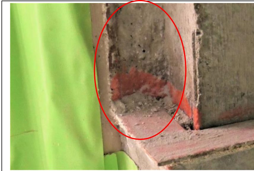
腰壁入隅部の清掃不良
