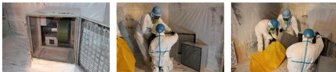
図 4.7.85 HEPAフィルタの交換
