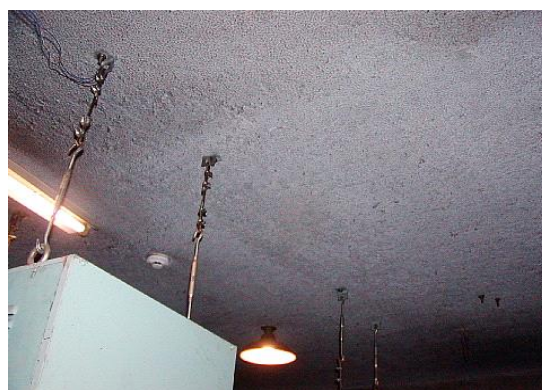
天井、一部に吊りボルト増設の痕あり、一部で剥落箇所あり
