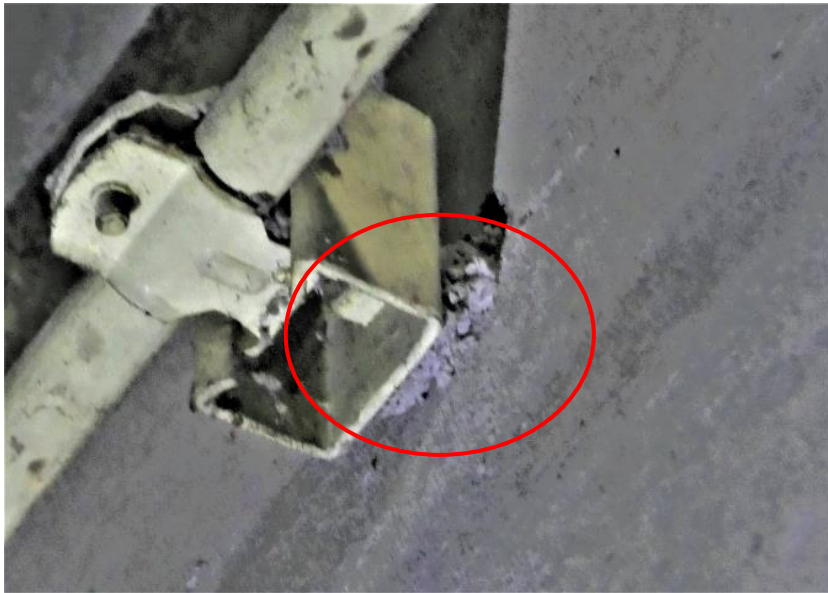
電線管ダクター部の清掃不良
