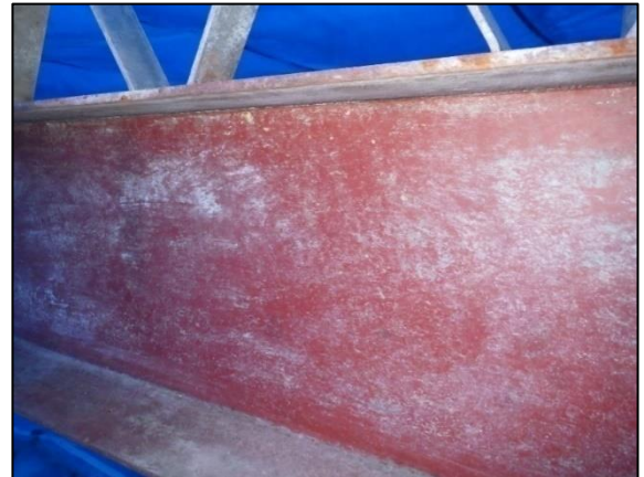
図 4.7.70 再付着した石綿の例
