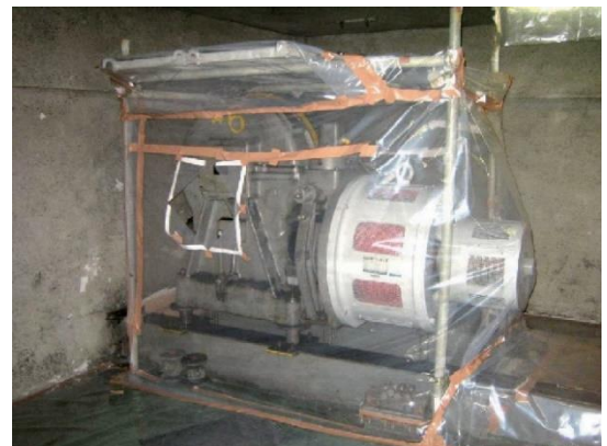
図 4.7.26 作業場内部の養生例 (エレベーター機械：接触防止用に布板敷き、発生熱を放散させる小窓を設置)
